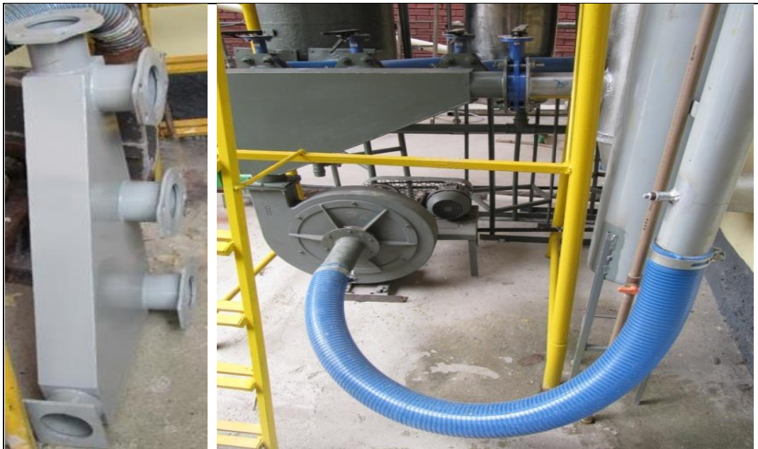
Figura 3.14 – Conjunto de manuseio de gases, a direita o trocador de calor, ao centro o ventilador centrífugo e na parte superior o distribuidor de gases com as válvulas.
