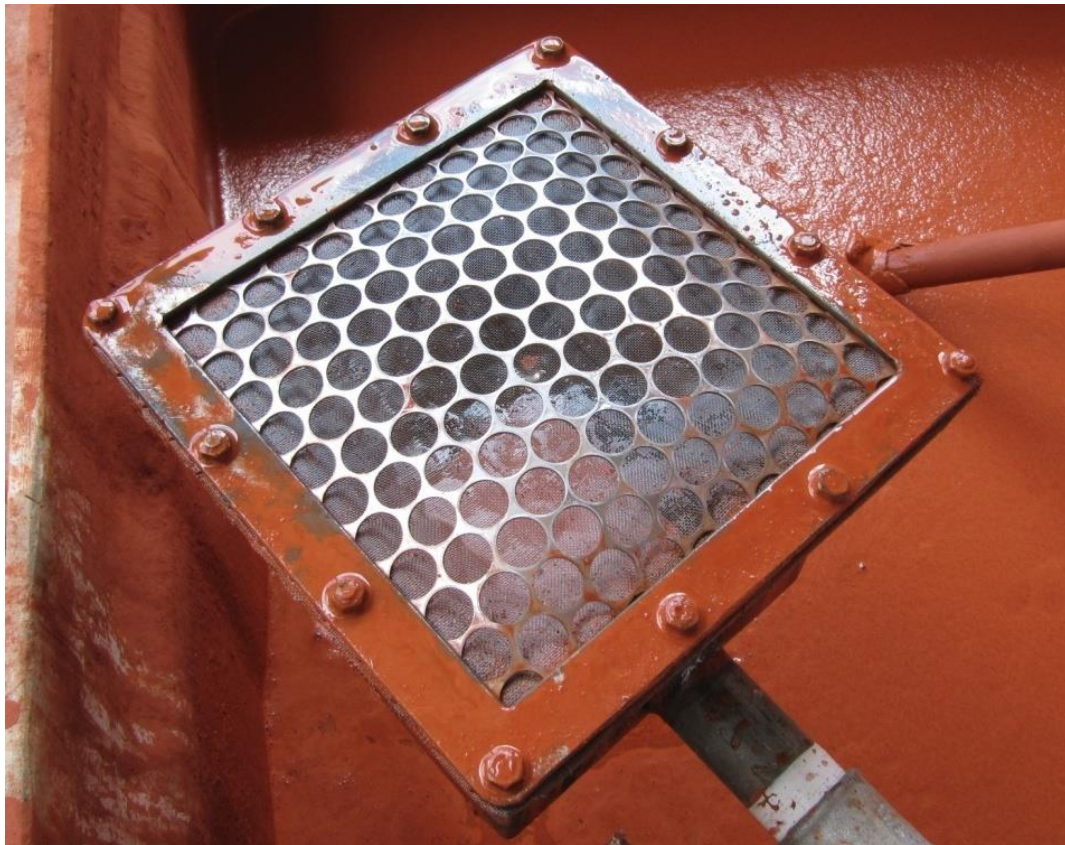
Figura 3.21 – Caixa de peneiramento pressurizado, destinada a remoção de areia.
