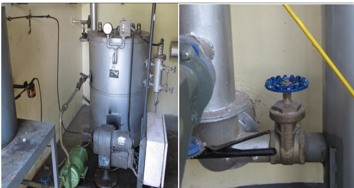
Figura 3.7 – Caldeira já existente utilizada como fonte de geração de gás de combustão e ponto de captação dos gases na base da chaminé da caldeira.
