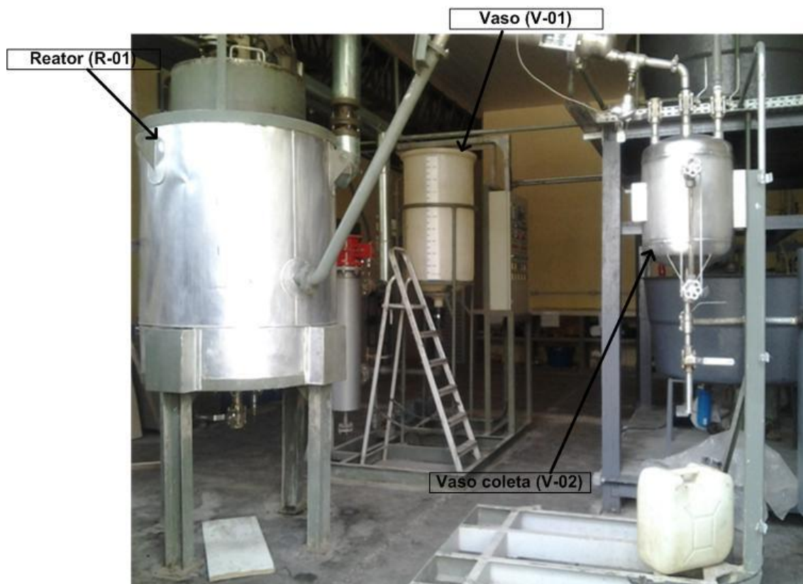
Figura 3 8 Unidade de Craqueamento em Escala Piloto
