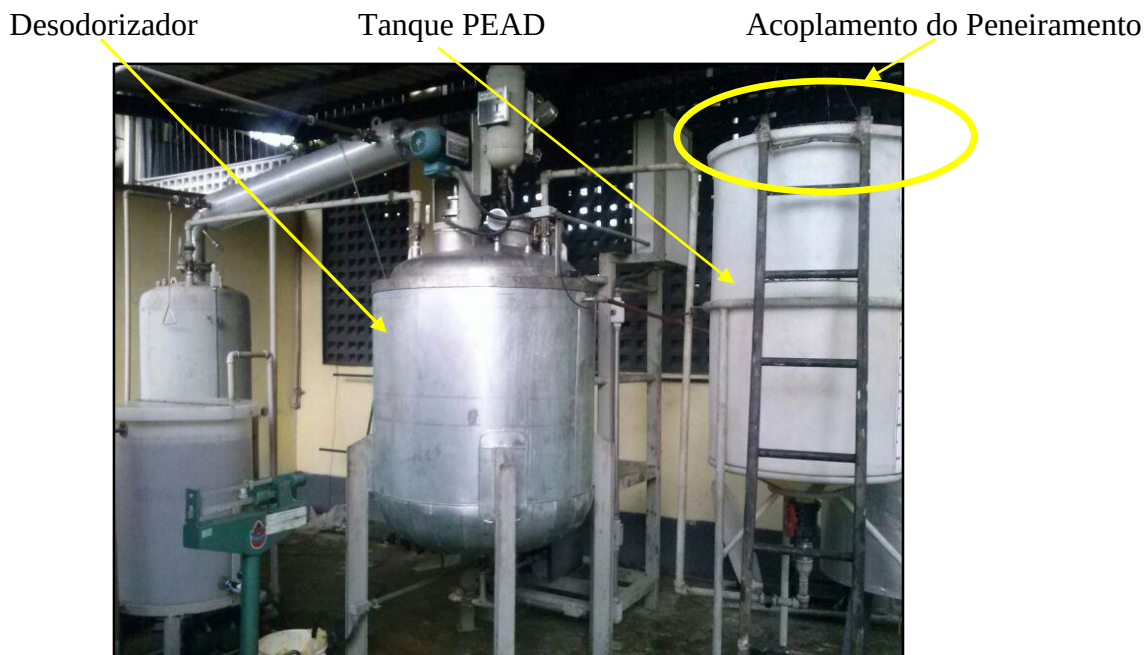
Figura 26- Unidade Piloto de Desodorização/Desidratação de 750 L
